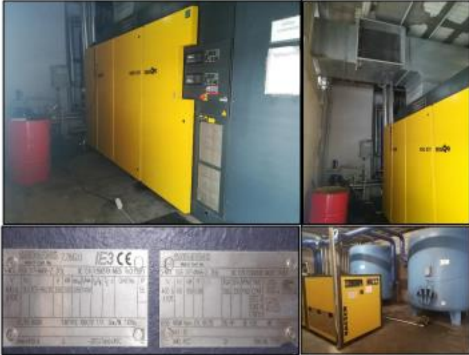
Şekil 6.3. Kaeser kompresör, egzoz kanalı, elektrik motorları etiketi ve kurutucu ve basınçlı hava tankı
