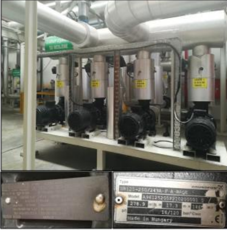
Şekil 3.5. Chiller 2 evaporatör pompaları (eşanjör 2 su besleme pompaları) ve etiket bilgileri
