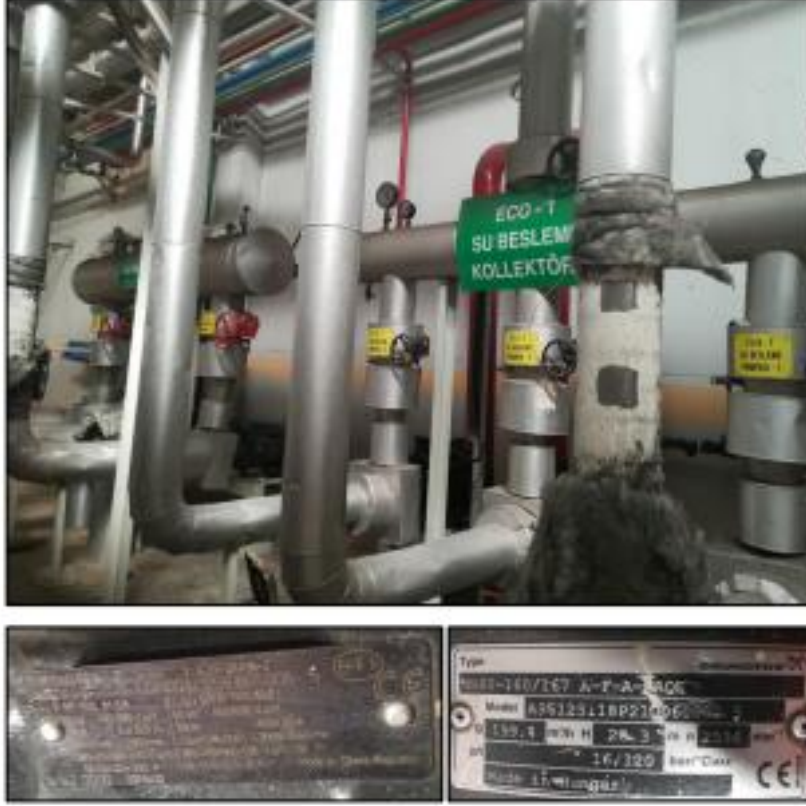
Şekil 3.7. Chiller 2 Eco-1 su besleme pompaları ve etiket bilgileri
