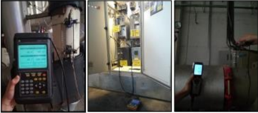
Şekil 4.6. Chillerlerde ultrasonik sıvı debimetresi ile debi, enerji analizörü ile aktif güç ve sıcaklık probu ile sıcaklık ölçümleri
