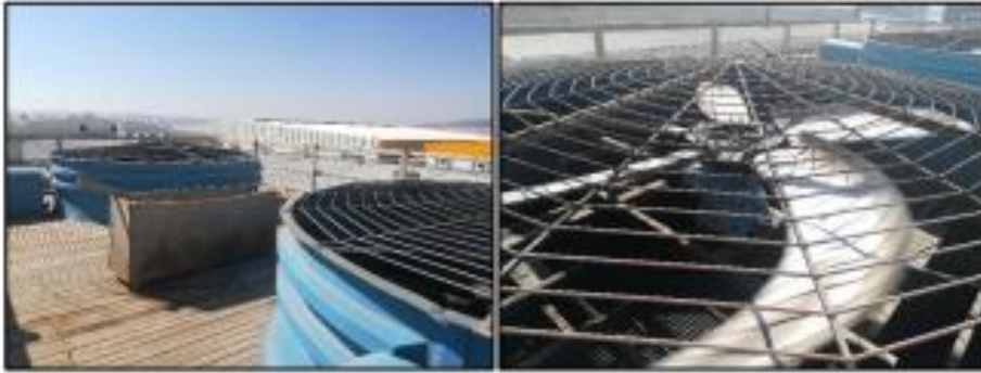
Şekil 5.3. Soğutma kulesi fanları
