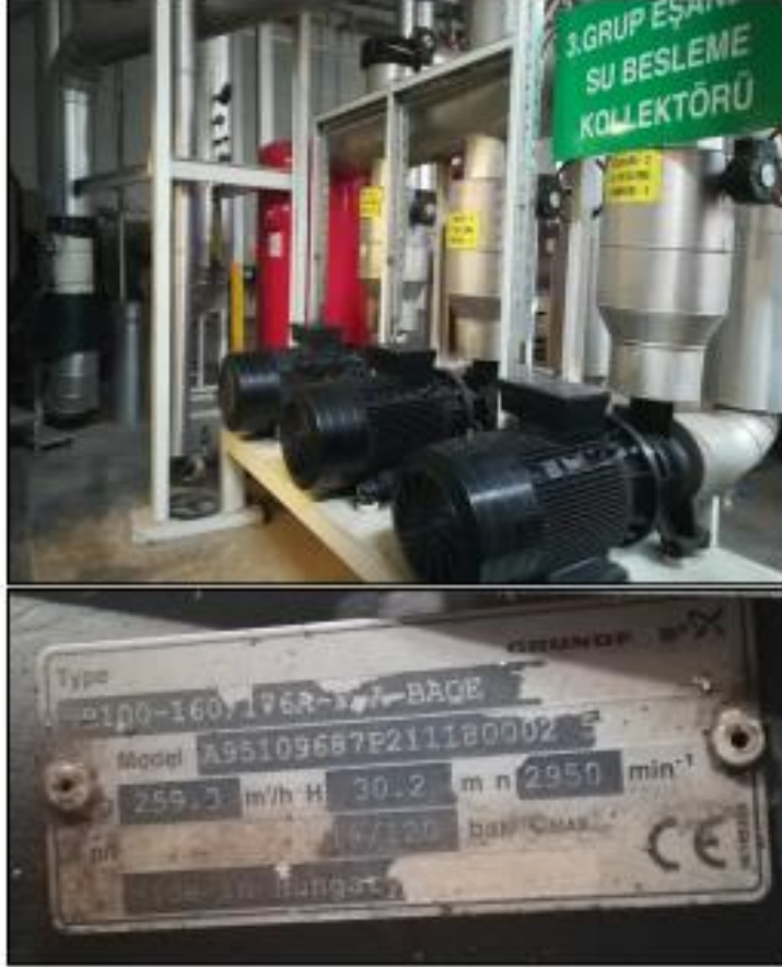
Şekil 3.2. Chiller 3 evaporatör pompaları ve etiket bilgileri
