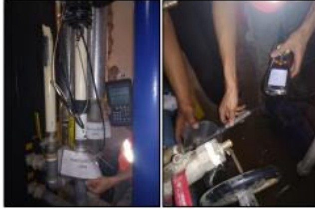
Şekil 6.8. Kaeser kompresör soğutma suyu ölçümleri
