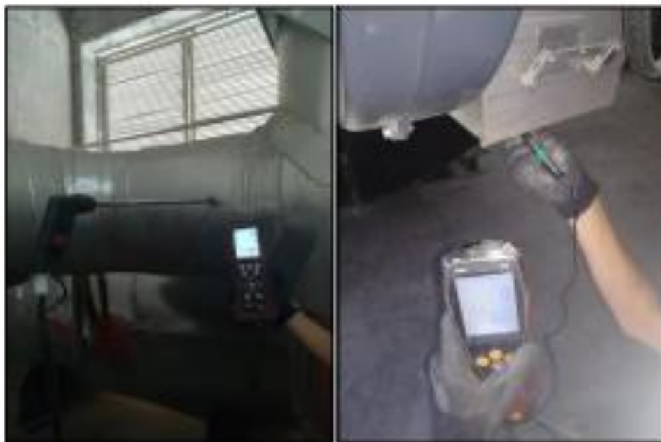
Şekil 7.6. Baca gazı analiz cihazı ile baca gazı analizlerinin yapılması ve 16 mm pervane hız probu ile brülöre taze hava giriş hızı ölçümü
