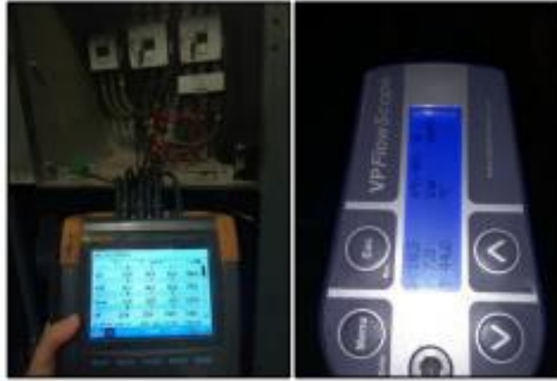
Şekil 6.7. Kompresörlerde enerji analizörü ile aktif güç ölçümü ve basınçlı hava debimetresi ile debi ölçümü
