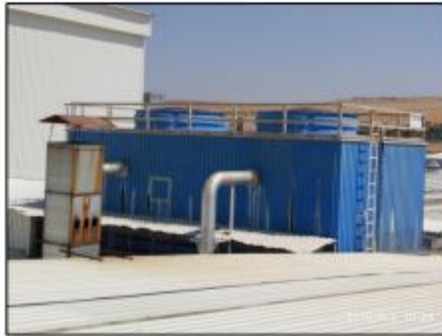
Şekil 5.2. İşletmede bulunan soğutma kulesi
