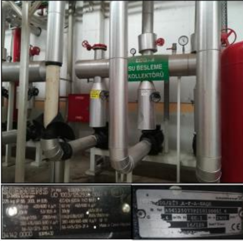
Şekil 3.9. Chiller 2 Eco-4 su besleme pompaları ve etiket bilgileri
