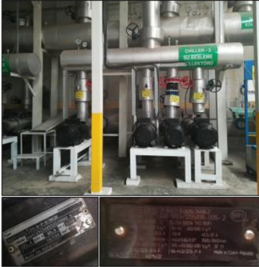
Şekil 3.4. Chiller 2 kondenser pompaları (chiller 2 su besleme pompaları) ve etiket bilgileri
