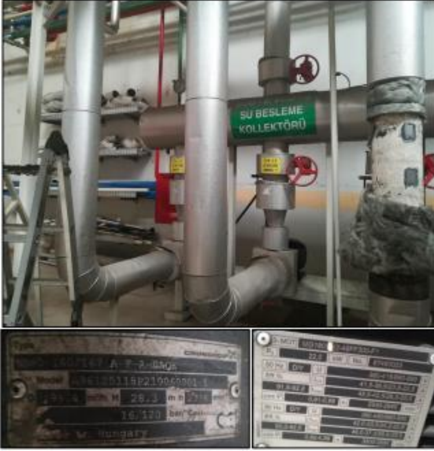
Şekil 3.6. Chiller 2 Eco 2, 3 su besleme pompaları ve etiket bilgileri
