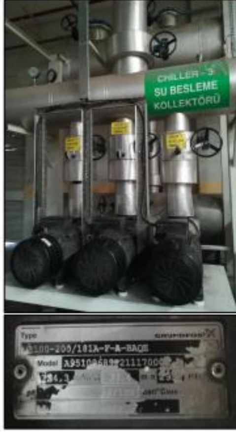
Şekil 3.3. Chiller 3 kondenser pompaları ve etiket bilgileri
