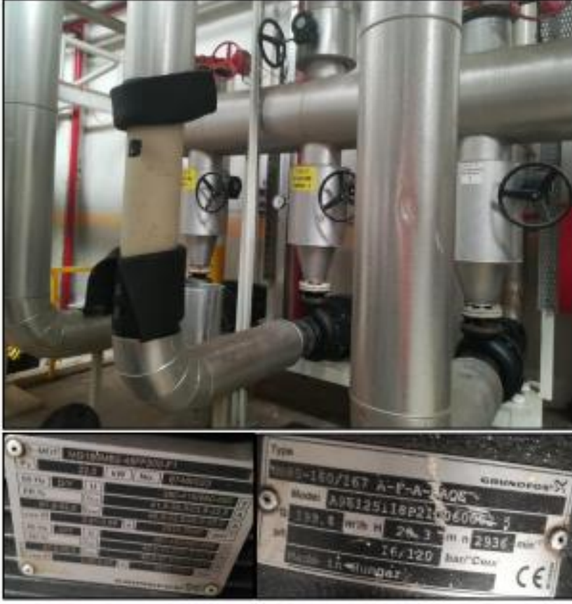
Şekil 3.8. Chiller 2 Eco-5 su besleme pompaları ve etiket bilgileri
