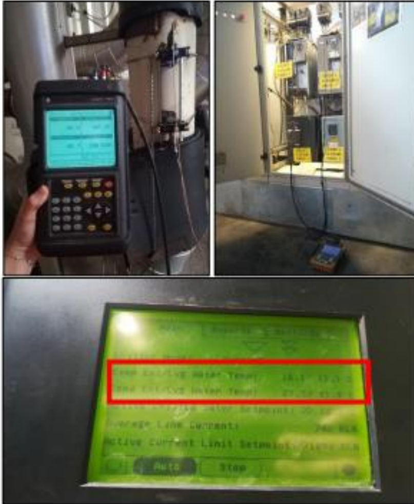
Şekil 3.11. Ultrasonik sıvı debimetresi ile debi ölçümü, enerji analizörü ile aktif güç ölçümü ve chiller ekranından akışkan sıcaklıklarının alınması
