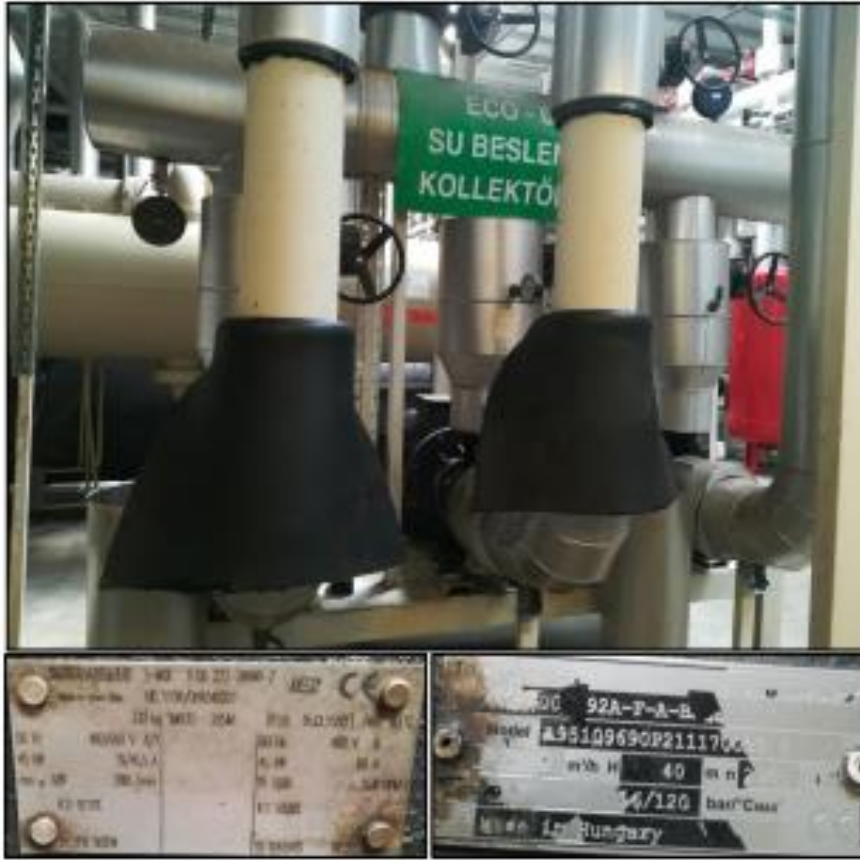
Şekil 3.10. Chiller 3 Eco-6 su besleme pompaları
